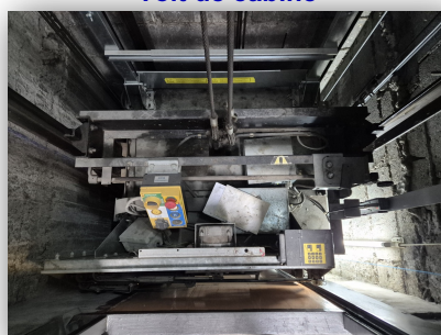
Toit de cabine
