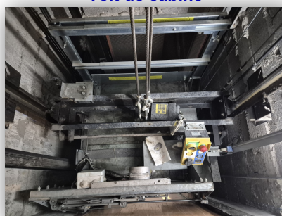
Toit de cabine
