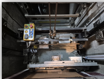
Toit de cabine
