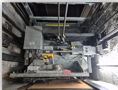
Toit de cabine
