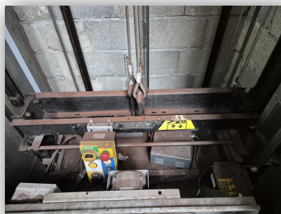
Toit de cabine
