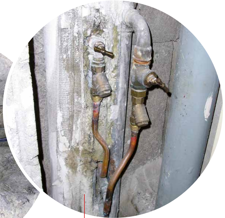
TRAVAUX SUR LES CANALISATIONS INTÉRIEURES VERTICALES DES APPARTEMENTS ET CHAMBRES DE SERVICE
