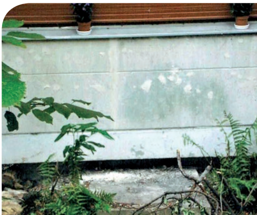
► Trumeaux en pierre AVANT réfection
